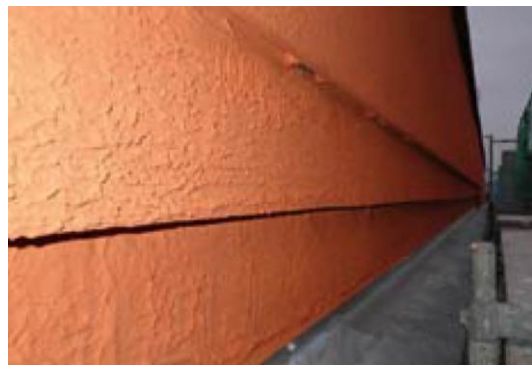
Figuur 14: Dubbellaags vlemuisverblijf in de betimmering opstaande dakrand als onderdeel van de dakconstructie. Uitvoering als dubbellaags boeiboord is ook mogelijk.
