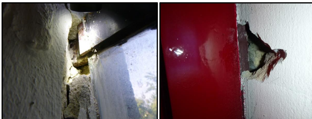
Onderzoeker heeft destructief onderzoek uitgevoerd aan kozijnaansluitingen in buitengevels, hierbij zijn geen asbestverdachte toepassingen aangetroffen.
