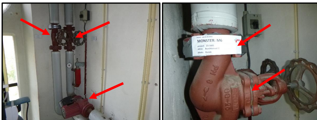
Bron 1/M6: asbesthoudende pakkingen tussen flenzen cv-leidingen.
