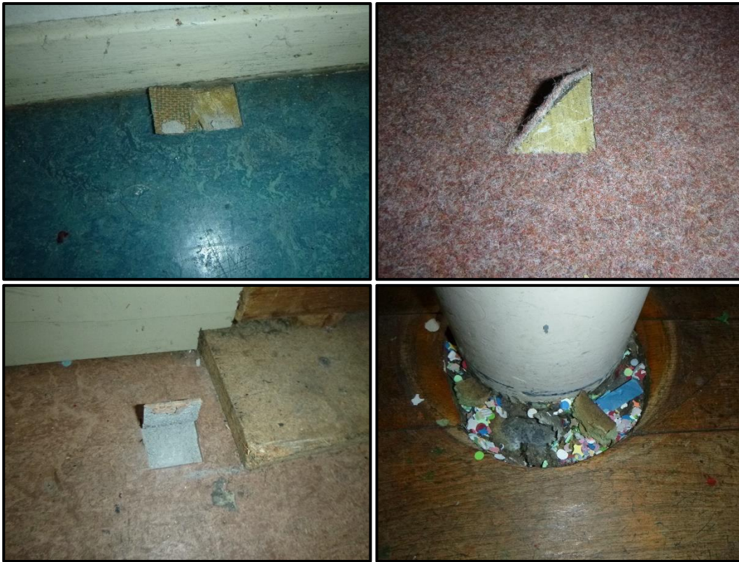
Onderzoeker heeft destructief onderzoek uitgevoerd aan vaste vloerafwerkingen, hierbij zijn geen asbestverdachte toepassingen aangetroffen.
