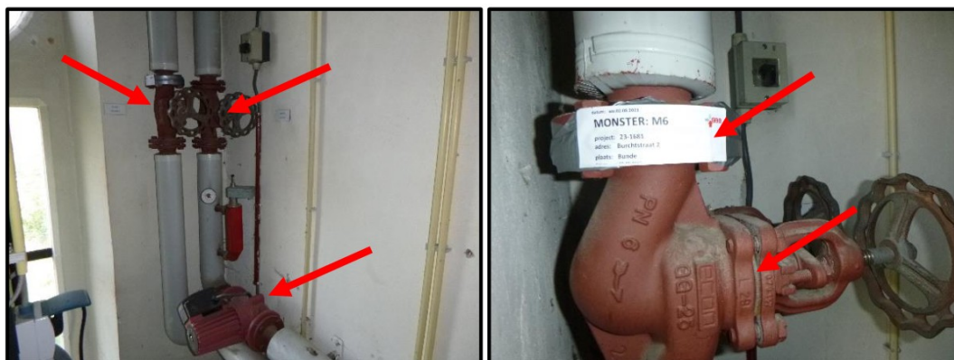
Bron 1/M6: asbesthoudende pakkingen tussen flenzen cv-leidingen.
