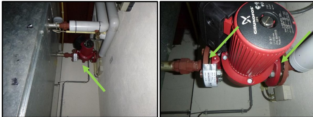
M9 – pakkingen t.p.v. pomp LBK, niet asbesthoudend.
